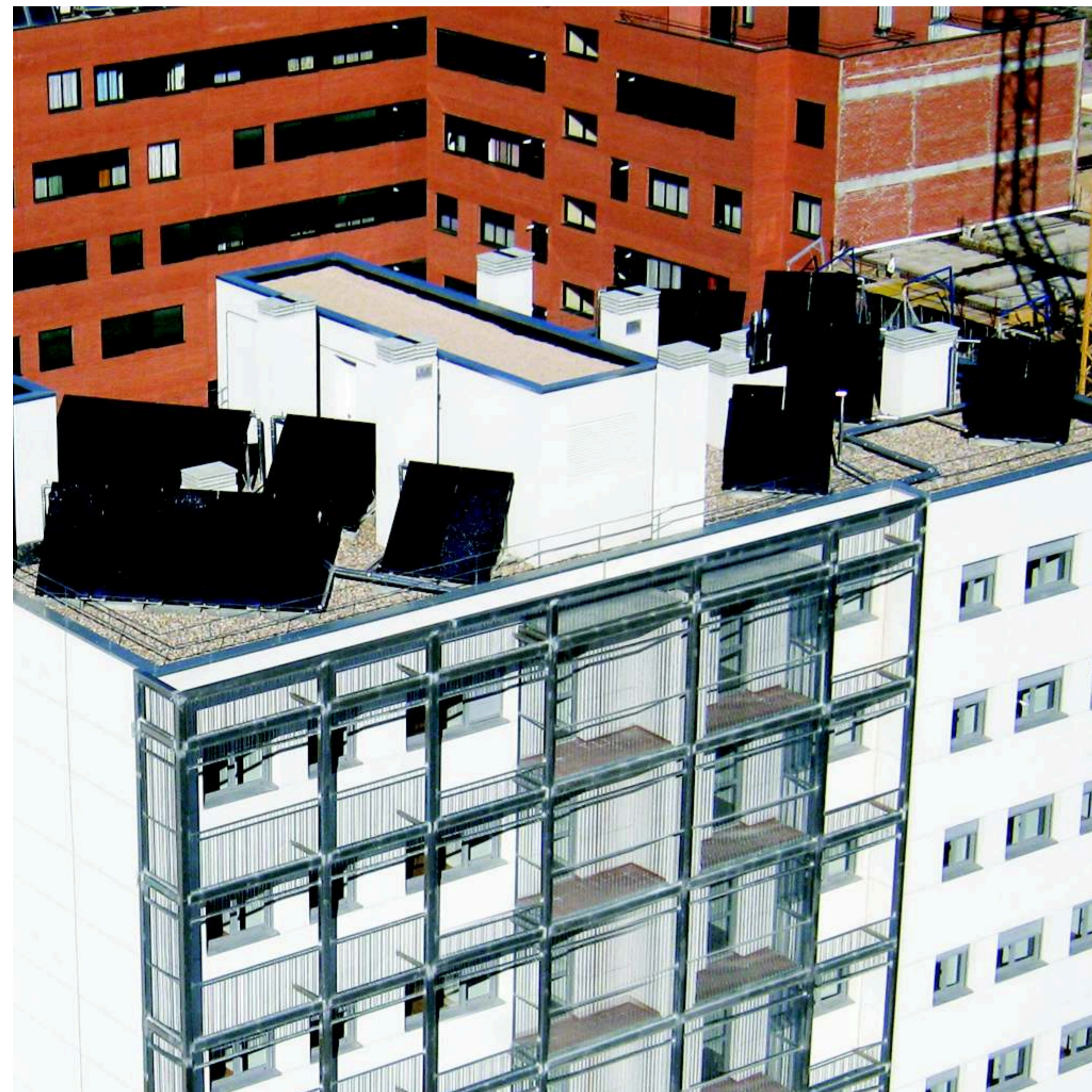
Paneles solares para producción de agua caliente
